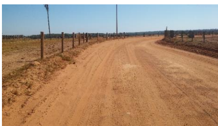
Figura 23: Curva com grau considerável de erosão.
