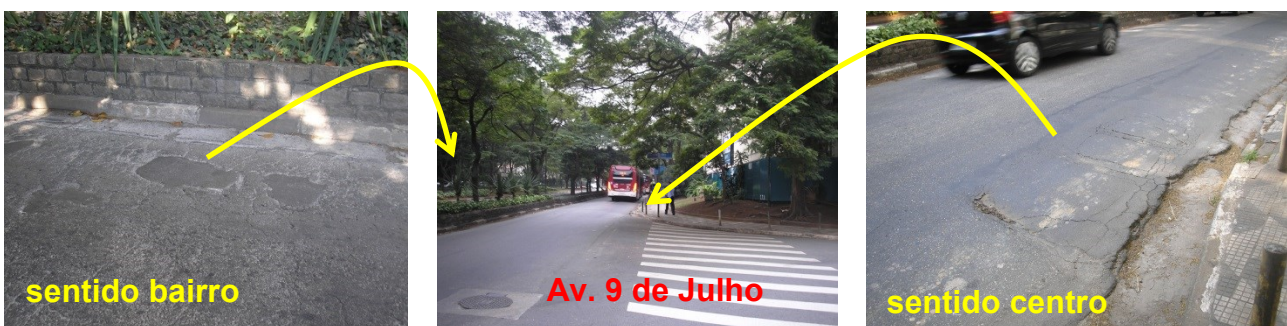
Figura 8 – Irregularidades observadas no asfalto da Avenida 9 de Julho
