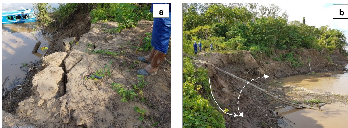
Figura 9 – (a) Rachaduras na superfície do terreno da figura b. (b) Margem oposta ao distrito de Calama, com a superfície de ruptura em perfil (linha sólida) e feição de semi-circunferência em planta (linha pontilhada) após um escorregamento rotacional.
