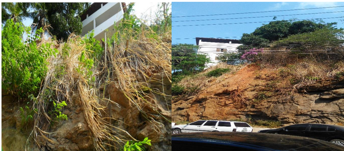
Figura 6 – Edificações construídas sobre Afloramentos Rochosos Fonte: O autor, 2018
