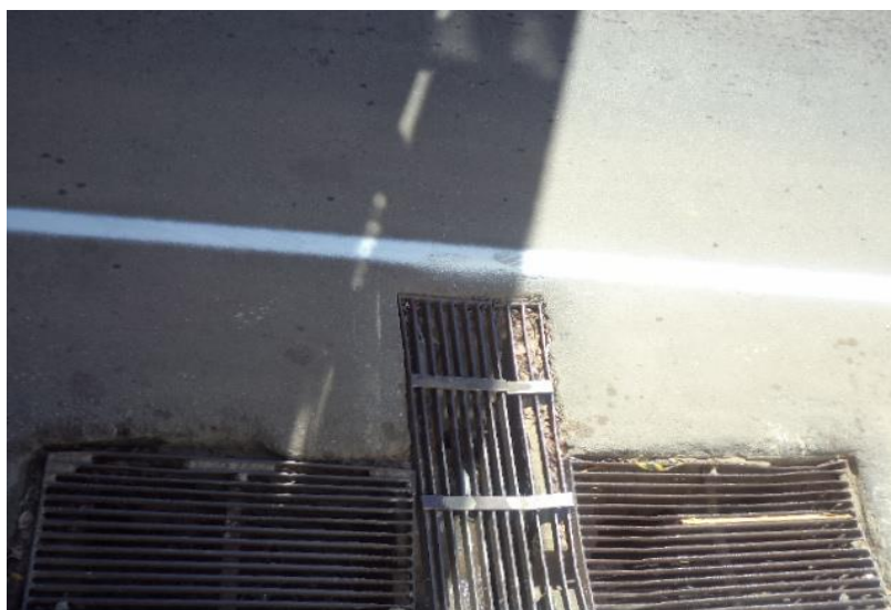
Figura 6. Equipamentos de drenagem encontrado no ponto de alagamento da Avenida Beira Rio, abaixo da Ponte de Ferro.
