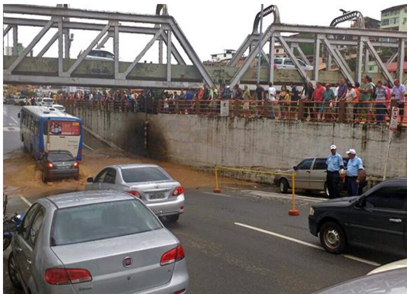
Figura 5. Ponto de alagamento na Avenida Beira Rio, abaixo da Ponte de Ferro.
