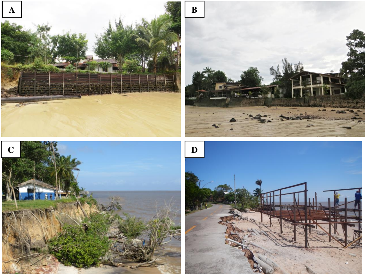
Figura 5 – A: Restos de uma propriedade e árvores caídas; B e C: Barracas situadas na borda da falésia sob erosão; D: Destruição da estrada pavimentada que dá acesso à praia e barraca sendo reconstruída.
