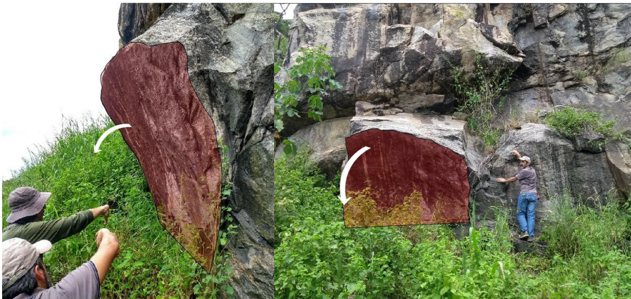
Figura 7. Setor do talude estudado, ilustrando o mergulho subvertical da foliação tectono-metamórfica para o interior do talude condicionando tombamento de blocos.
