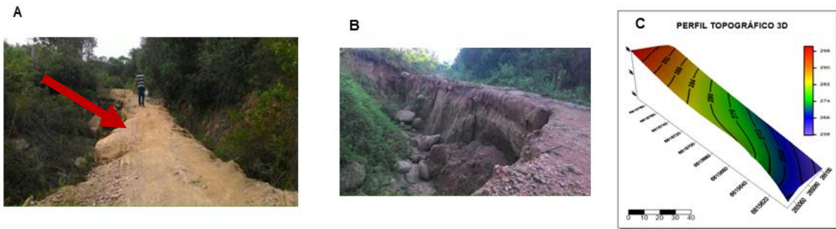
Figura 9- A)Parte da estrada mais crítica, local indicado pela seta a estrada possui apenas 76 cm de largura, sendo que inicialmente possuía em torno de 1.70 metros; B) Vista da estrada que foi erodida; e, C) Perfil topográfico ao longo da estrada da Cascata. Cores quentes representam altitudes mais elevadas enquanto que as frias, menores altitudes.
